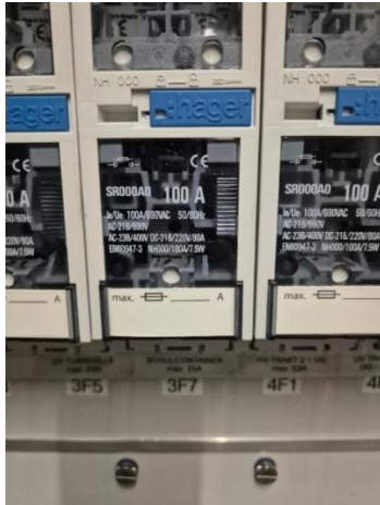
Anschluss Schulcontainer 25 A
