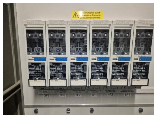
Anschluss Sicherungen Hauptverteilung
